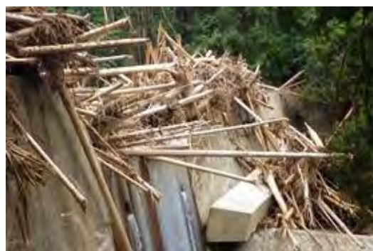
写真-1 大量の流木による堰堤の損傷
