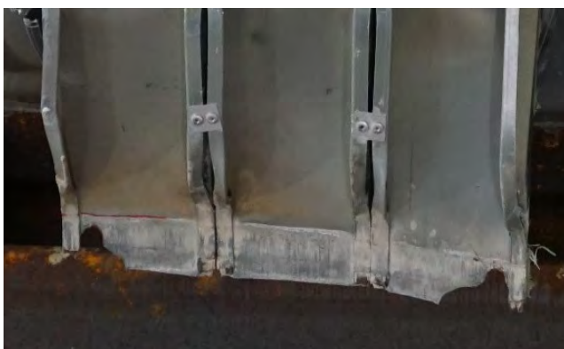
図-12 実験後の F-15 試験体デッキ端部
