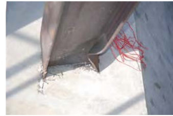
写真-2 実験終了後における支柱基部の変形状況
