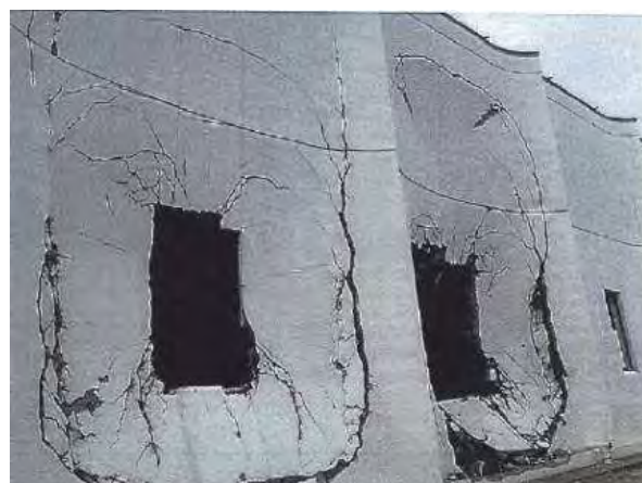
写真-1 曝気槽送風機室外壁の損傷 (仙台市建設局)
