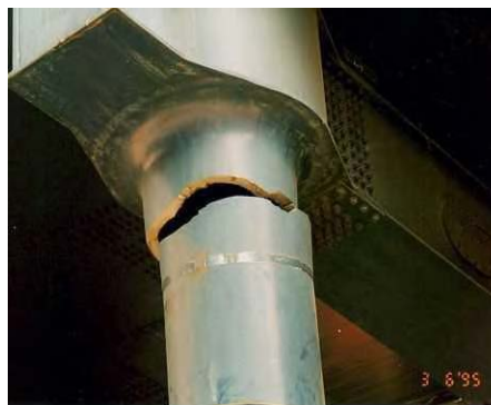
写真1 鋼製橋脚上部に生じた脆性的な破壊
