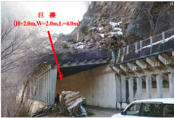
図-5 被災したロックシェッドと巨礫
