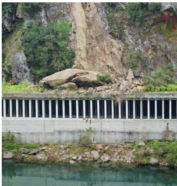
崩壊斜面とロックシェット全景
