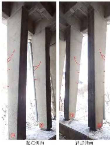
柱の曲げひびわれ
