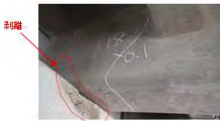
主桁ひびわれ，橋座端圧壊
