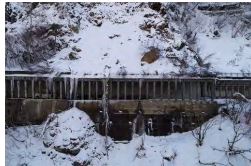
図-3 崩壊斜面の状況
