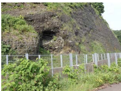
写真-1 従来型落石防護柵
