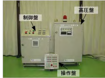
図-2 放電衝撃破碎装置の外観
