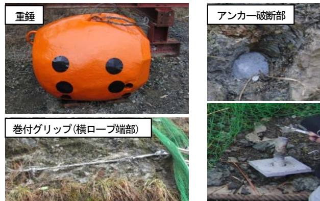
写真-2 重錘・巻付グリップ・アンカー破断状況
