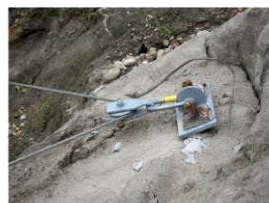
滑車装置（アンカー部）
