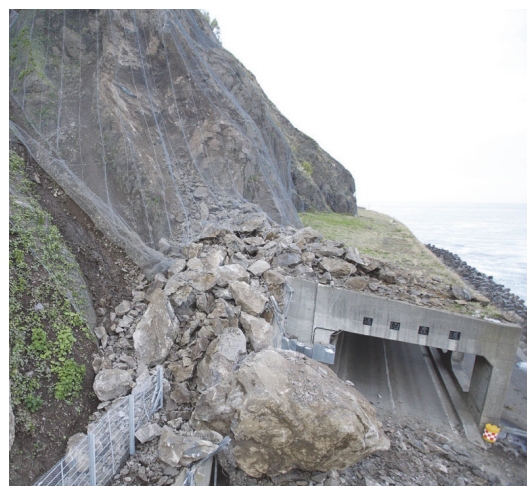
写真-1 落石による道路災害例(2008)
