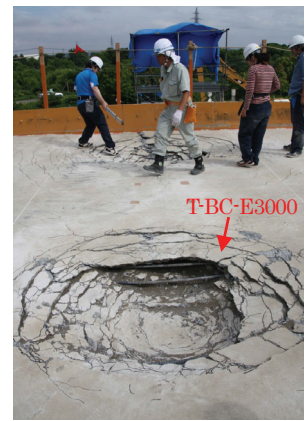
写真-2 ひび割れ状況
