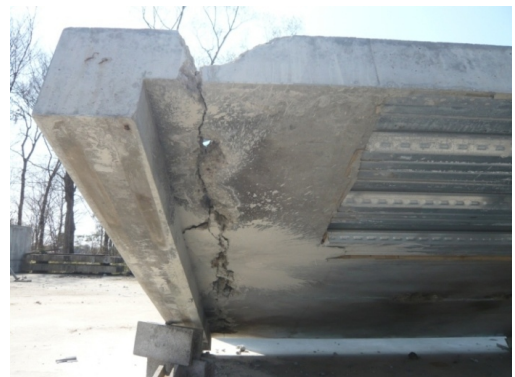
写真-14 RC スラブ裏面の破断状態
