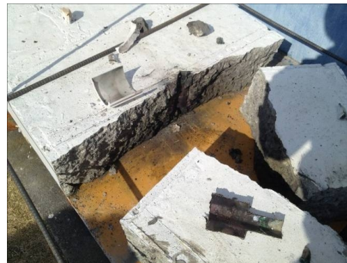
写真-4 スラブ短辺方向での破断面形成状態
