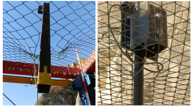
(a) No.3 (鋼製材) (b) No.6 (鋼製パイプ) 写真-4 ネット破断状況
