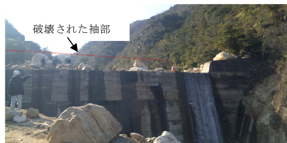
写真-1 コンクリート砂防堰堤袖部の破壊
