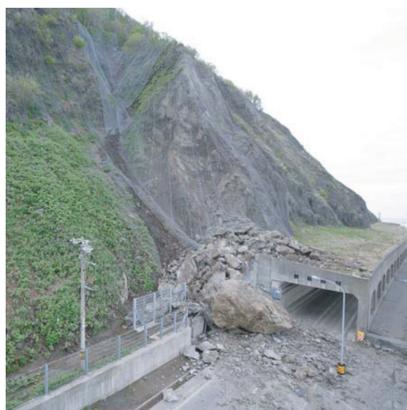
写真-1 ロックシェッド入り口付近の落石 (2008.5)
