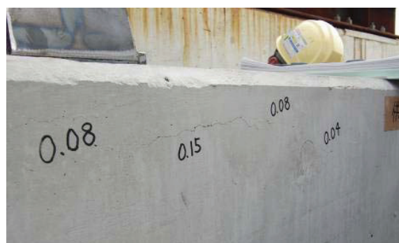
写真-2 クラックの発生状況
