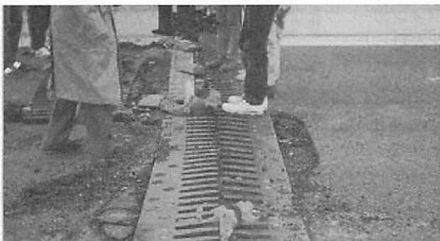
写真-1 伸縮装置の損傷
