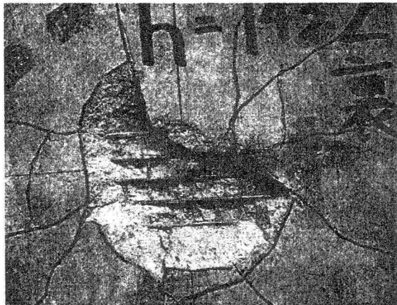
写真 7 鉄筋コンクリート版の裏面剥離状態
