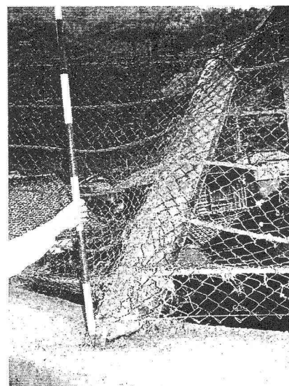
写真-2 落石防護柵の被災状況 (支柱②)
