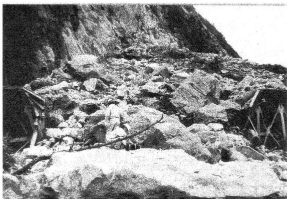
写真—1 完全破壊した防護壁⑪～⑫
