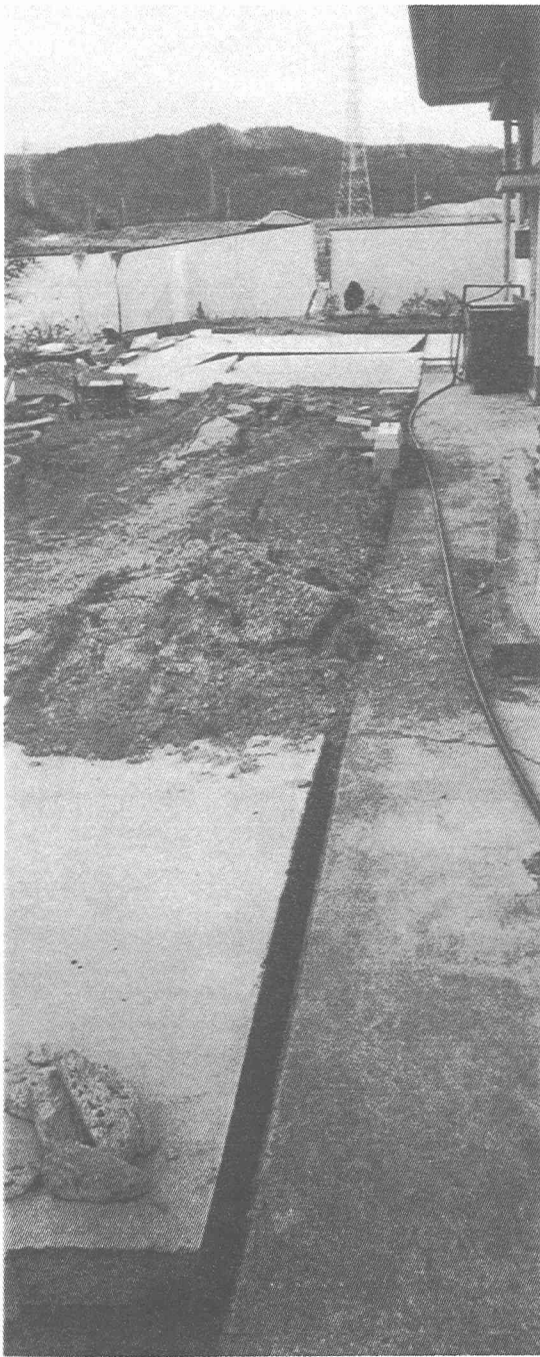
写真-15 河野 道信氏邸裏庭を通る小倉地震断層 矢印は母屋基礎コンクリートを貫通する断層の位置.
