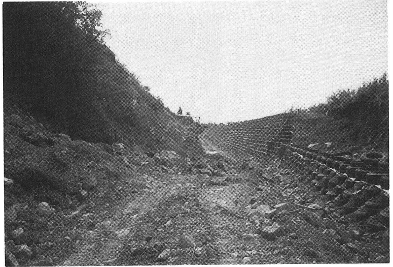
写真6 フランスの落石防護ポケット (Aigle-Evian)
