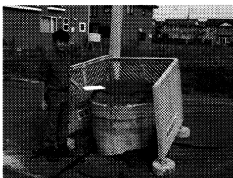
図-1 マンホールの浮上事例 (2003年十勝沖地震)
