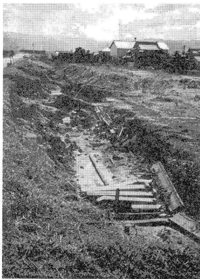
図-11 台風 9918 号に伴う高潮による農業排水路の破損状況
