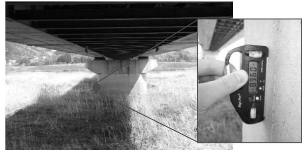
(h) P4橋脚傾斜(最大0.4°)
