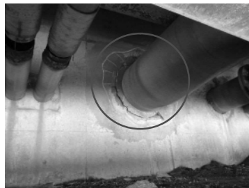
(d) A1橋台胸壁部添架管周辺コンクリートの剥離・ひび割れ
