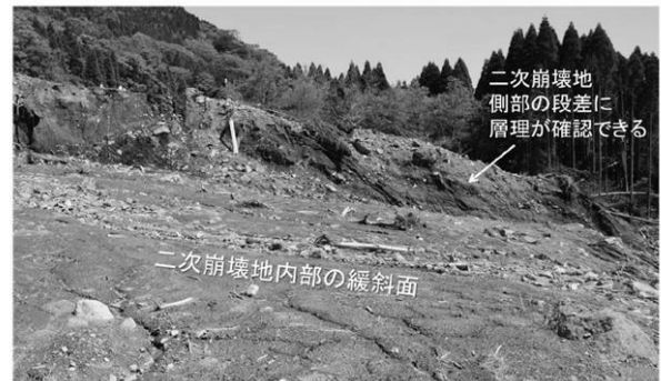
図-6 二次崩壊地内部の緩斜面と層理（遠望撮影） 2)
