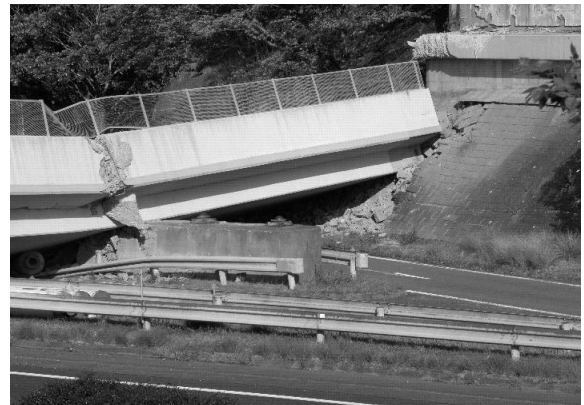
写真-2 A1側桁端部落橋状況
