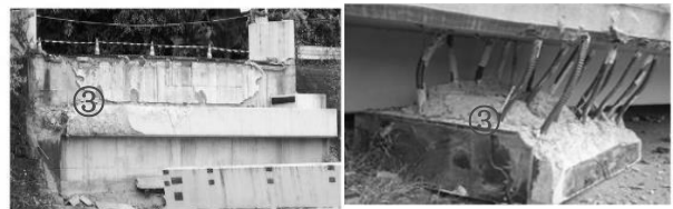
写真-3 A1側変位制限構造の損傷(鋭角側)
