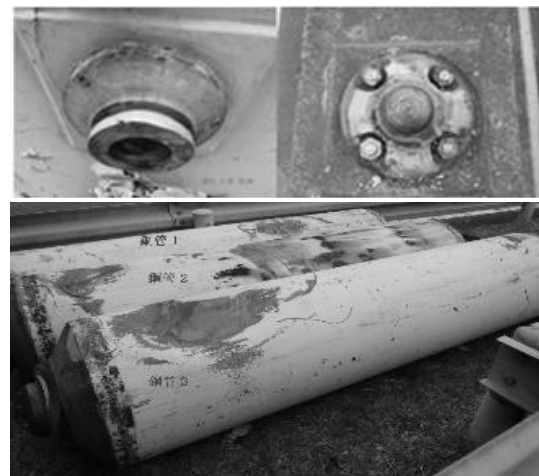
写真-5 橋脚ピボット支承逸脱
