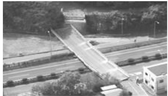
写真-1 橋梁落橋状況
