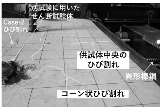
写真-7 Case-3 供試体上面のコーン状のひび割れ (荷重 850kN時点)
