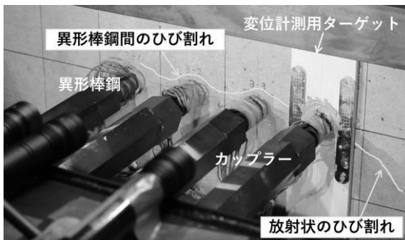
写真-6 Case-3 異形棒鋼間のひび割れと異形棒鋼を中心とした放射状のひび割れ (荷重 850kN時点)
