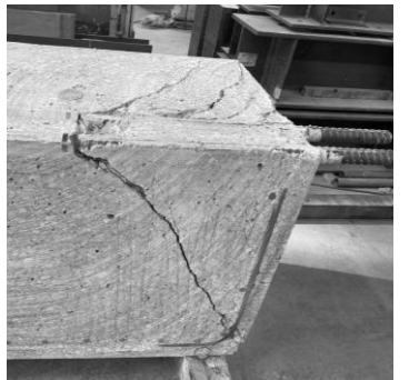
(a) Case-3 コーン状のひび割れ
