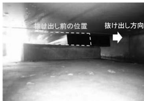
図2 ゴム支承におけるゴムの抜け出し 2) (文献2)に加筆)
