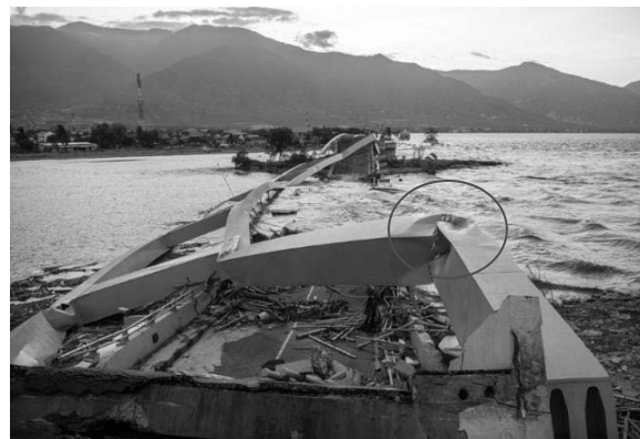
図-9 東側パル橋東側アーチリブ部座屈状況
