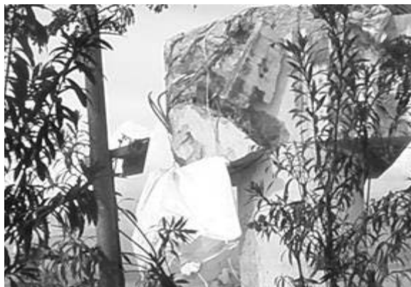
図-20 東側アーチ橋東側橋脚損傷状況(P3)
