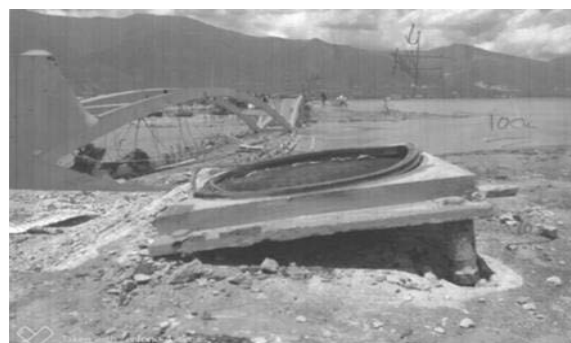
図-14 P2橋脚西側北支承損傷状況
