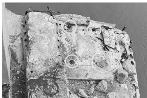
図-15 P1橋脚西側南支承損傷状況
