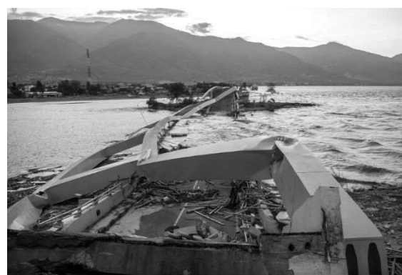
図-2 東側のパル橋におけるアーチリブ部の座屈状況
