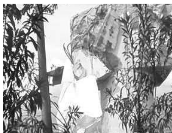
図-14 東側アーチ橋東側橋脚の損傷状況
