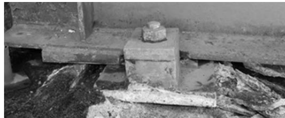
写真-2 過度な橋軸方向の変位による桁の落下
