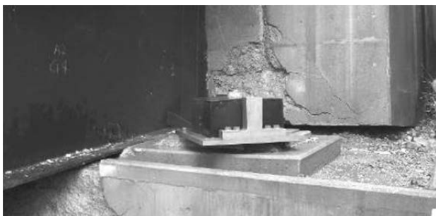
写真-3 水平力分散ゴムにおける桁の落下
