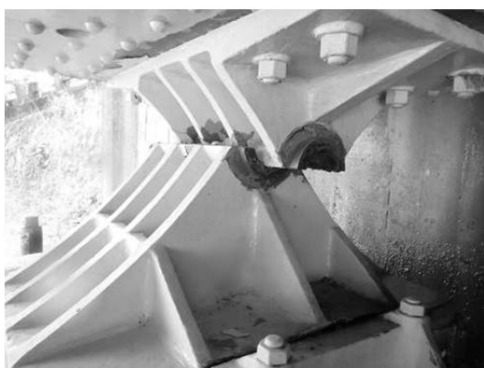
写真-5 ピンローラー支承におけるピンの損傷
