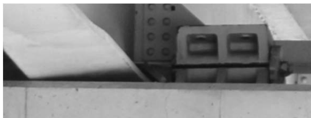
写真-1 ピン支承における桁の脱落
