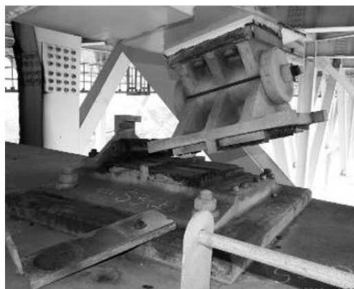
写真-6 サイドブロック取付ボルトの損傷による 桁の浮上がり(ピンローラー支承)
