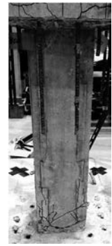
図-13 コア部ひび割れ(S面)
