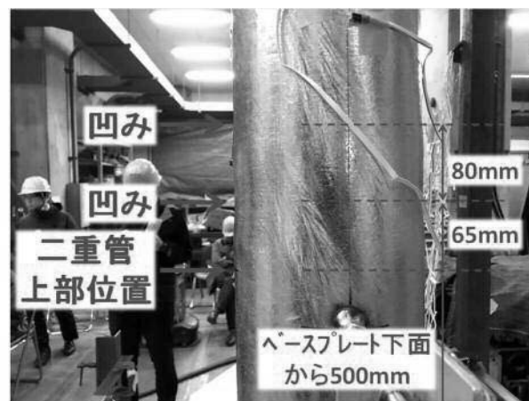
写真-3 二重管上部の凹み
