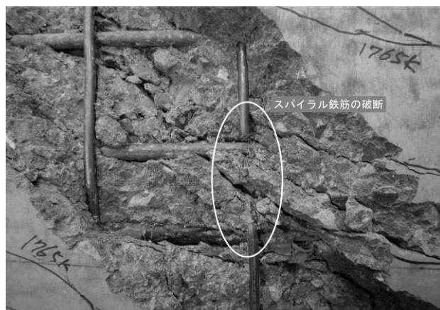
(b) 鉄筋破断箇所
