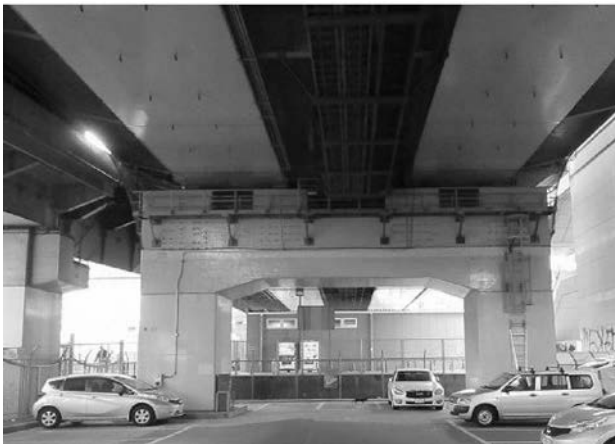
写真-1 地震計が設置された橋脚(P-21)
