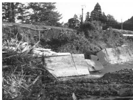
写真-1 A箇所降雨災害状況
