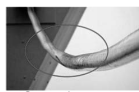
④ケーブルのよれ
