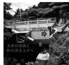
②主桁端部の A2 橋台 との衝突及び浮上がり
