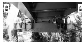
⑤P1支承部の破損
