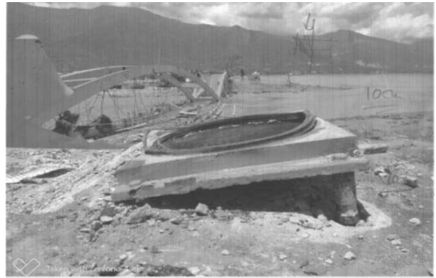
図-7 中間橋脚支承損傷状況
