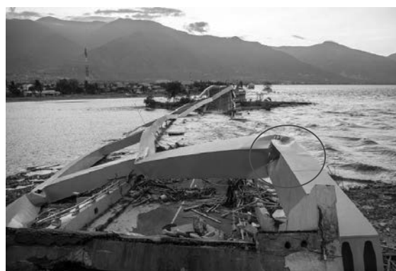
図－5 東側パル橋東側アーチリブ部座屈状況
