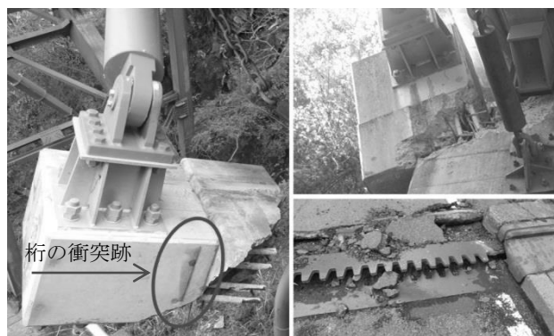
図-2 南阿蘇橋被災状況
