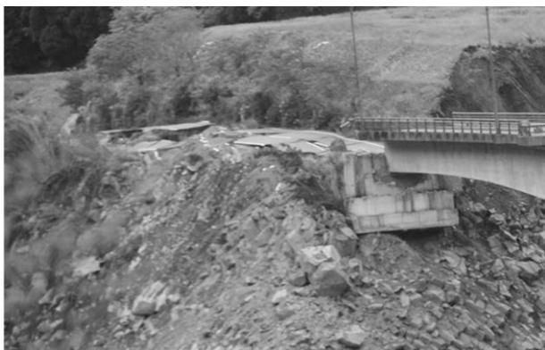
図-2 沈下した A1 橋台と損壊した背面道路
