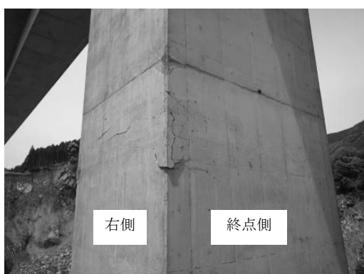
(a)外面のひび割れ状況
