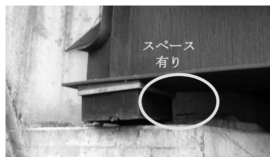
図-9 下査が損傷部位となった被災事例
