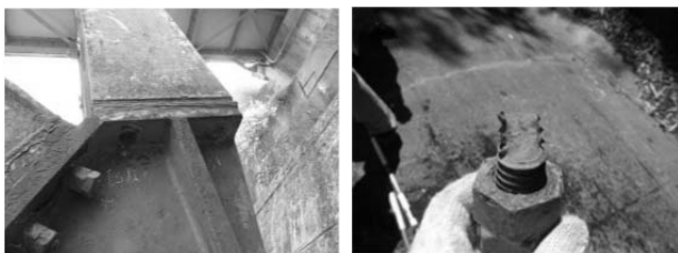
写真-3 ピン支承の接合ボルトの損傷状況
