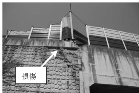
図-4 擁壁天端物および防護柵の被害の様子
