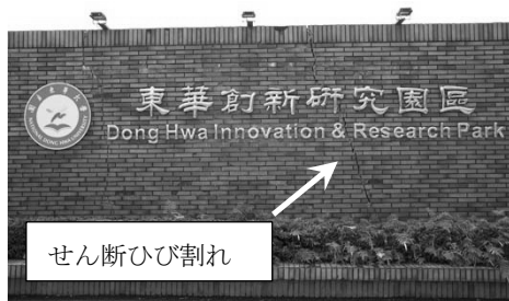
図-6 大学エントランス壁の被害
