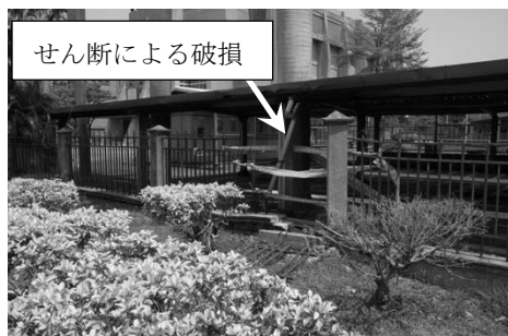
図-7 敷地境界部の柵の被害
