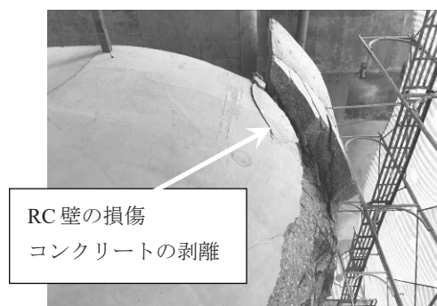
図-5 損傷した橋脚の被害の様子
