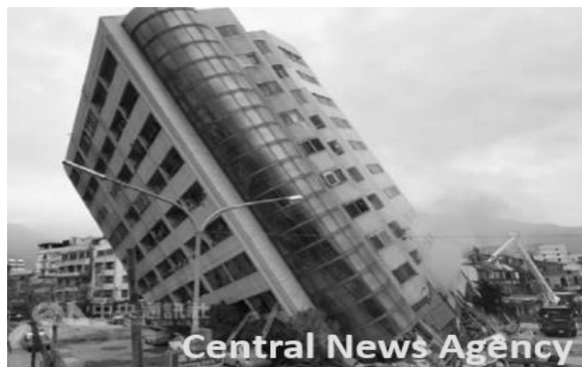
図-3 Yumen Tsuiti complex 損傷状況(文献1)
