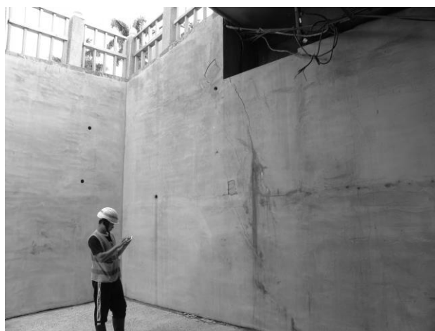
図－14 中正橋橋台ひび割れ図
