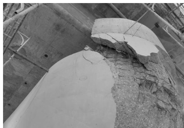
図－8 七星澤大橋 P1 橋脚損傷状況
