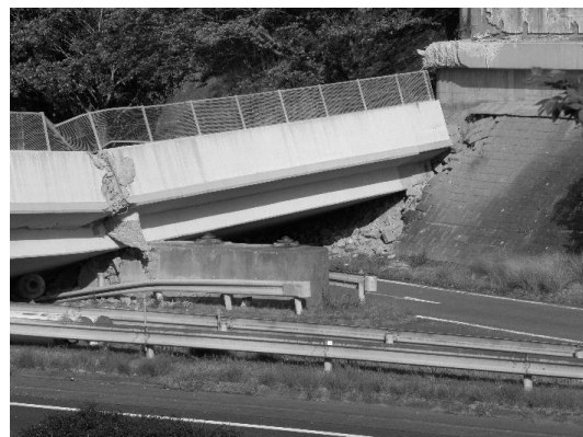
写真-2 A1側桁端部落橋状況
