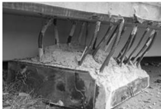
写真-3 A1側変位制限構造の損傷
