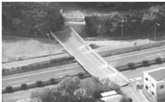
写真-1 橋梁落橋状況
