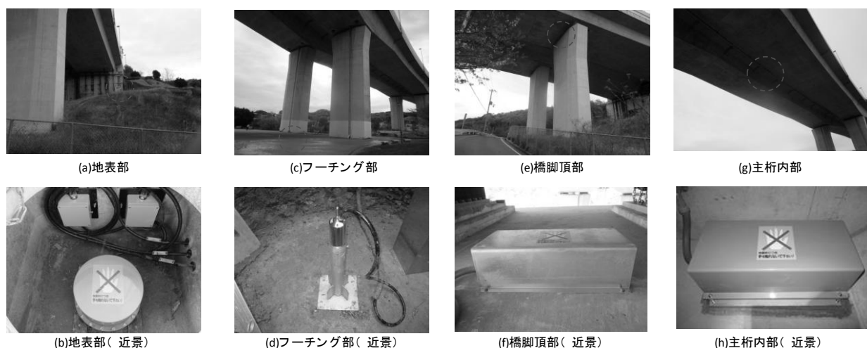
写真-2 地震計の設置状況例 (NO.21 垂水観測局)
