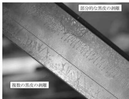
図-8 対傾構の黒皮の剥離
