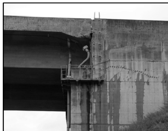
写真-1 桁衝突による橋台損傷事例
